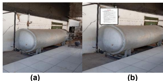
(a) (b) Gambar 4. Mesin autoclave yang belum dipasang safety procedure (a) dan rekomendasi mesin sudah dipasang procedure (b)
