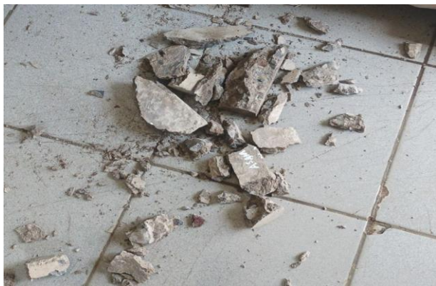
Gambar 4. Kerusakan Pada Sampel Beton Asam
