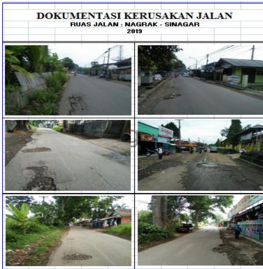
Gambar 2. photo visual kerusakan jalan ruas jalan : Nagrak - Sinagar
